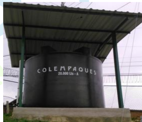
Tanque de almacenamiento No 4
