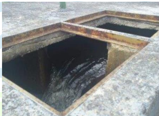
Ilustración 6. Cámara de quietamiento
