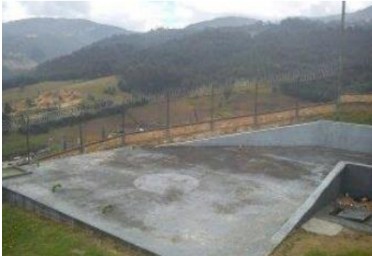
Tanque de Almacenamiento No 1
