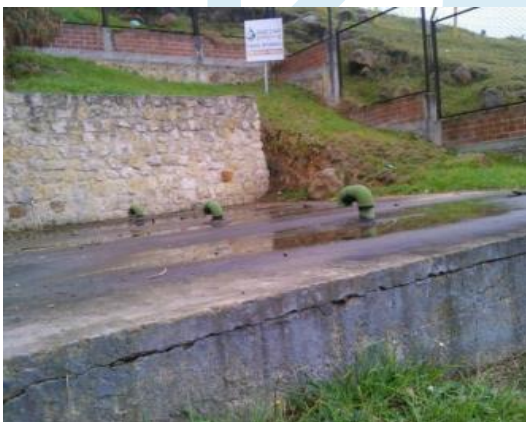
Tanque de Almacenamiento No 3
